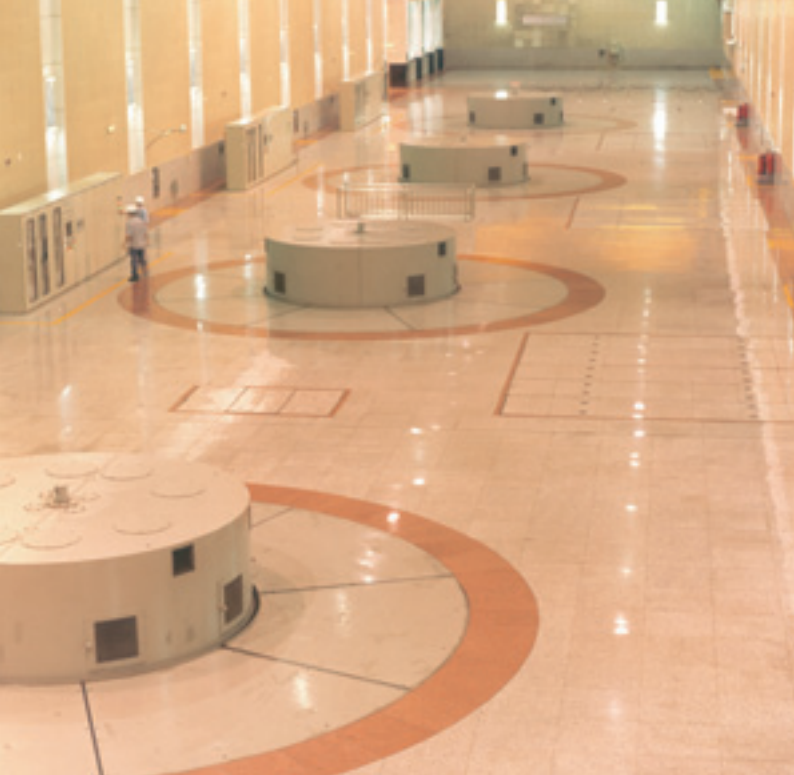
Pumpspeicherkraftwerk in China, Guangzhou, Generatorhalle
